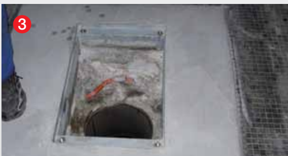
3 Der neue Einbaurahmen wird in den Boden versetzt und das Aussenrohr gekürzt
